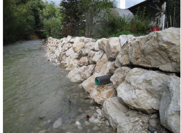
Abb. 2: Heute liegt Stein an Stein. Die Arbeiter der Flussmeisterstellen Piding und Traunstein haben die Ufersicherung wiederhergestellt.
