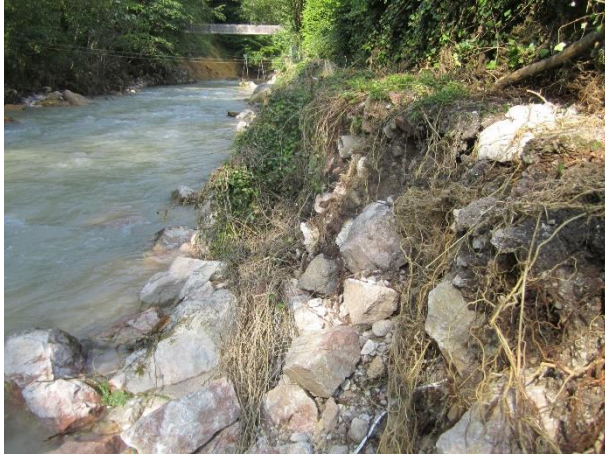
Abb. 1: Schwere Schäden hatte das Juli-Hochwasser im vergangenen Jahr auch im Färberwinkl in Bischofswiesen hinterlassen. Dort war die Bischofswiesener Ache über die Ufer getreten. Das Wasser riss die Steine mit, die Ufersicherung wurde zerstört.
