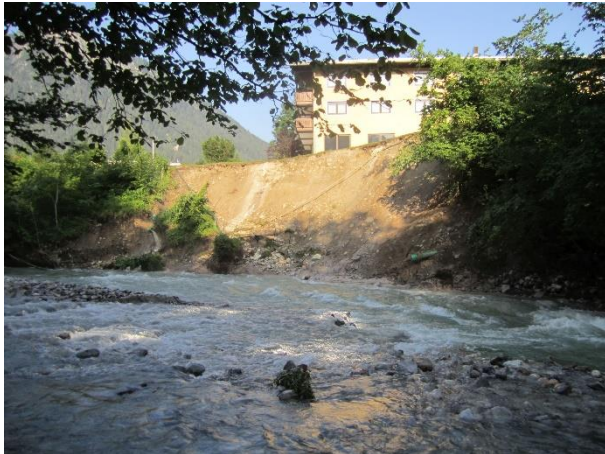
Abb. 3: Hubertus Anbruch: Der starke und anhaltende Regen hatte die Königsseer Ache in einen reißenden Fluss verwandelt. Die Kraft des Wassers war so groß, dass der Hang unterhalb des Hotel „Hubertus“ ausgehöhlt wurde. In der Folge rutschten Teile des Hangs ab. Das Hotel musste schließen.
